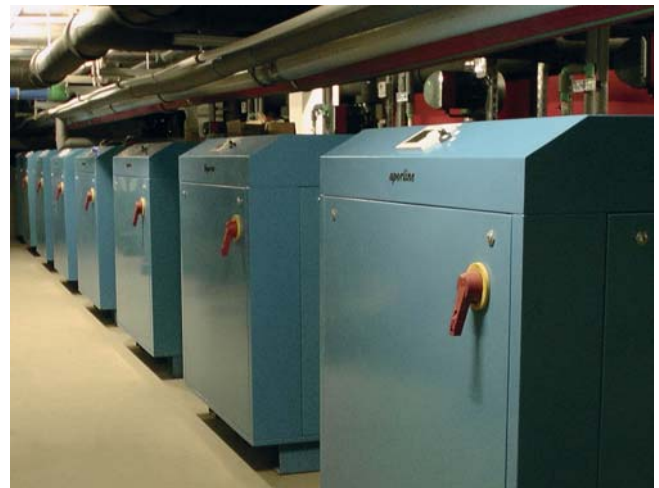
4. ábra. A B jelű épületrész pincéjében elhelyezett hőközpont magyar hőszivattyúkkal
