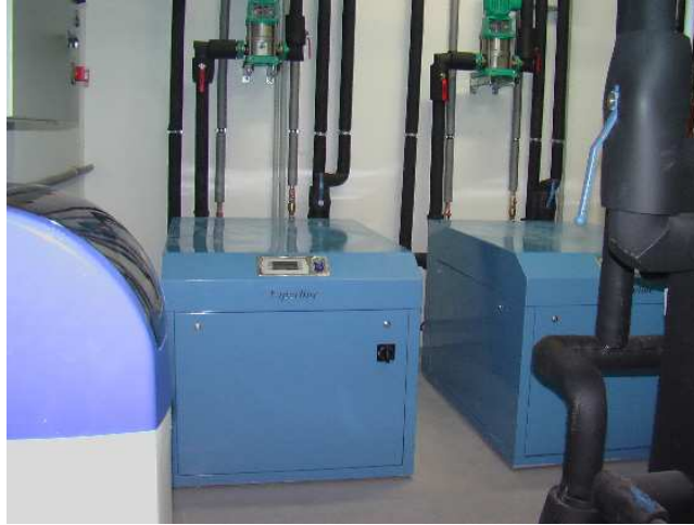
2. ábra. Hőszivattyúk elhelyezése az intézmény hőközpontjában
